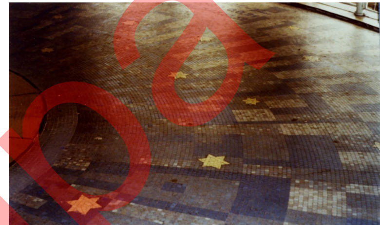
Magasin 2 - Extension Sauvage - Mosaïque de la terrasse panoramique - 1981 Archives de la Samaritaine, Service Travaux
