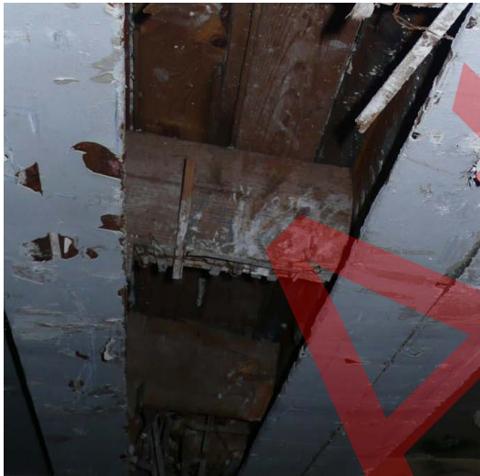
Solives au droit du raccordement de la galerie Monnaie et de l'ancien noyau du magasin, au niveau du n°19, rue de la Monnaie Cliché Attrapa - Février 2011
