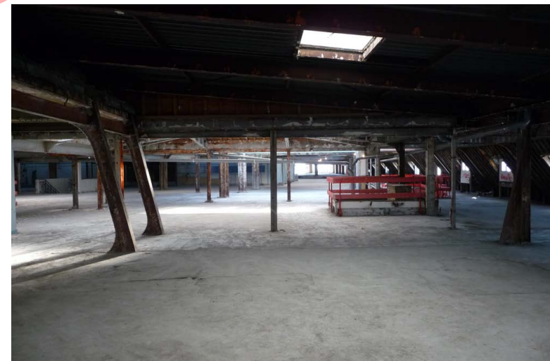
Magasin 2 - Plateaux Jourdain - Charpentes de combles en place au droit d'une cour bouchée Cliché Attrapa - Février 2011
