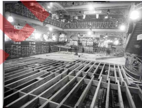
Magasin 2 - Verrières Jourdain - Clichés de 1939 sur lesquels le rétrécissement d'un des halls est visible Cliché Attrapa 500-01_216 et 500-01_212
